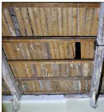
Die Decke über der Aula ist Sanierungsbedürftig.
